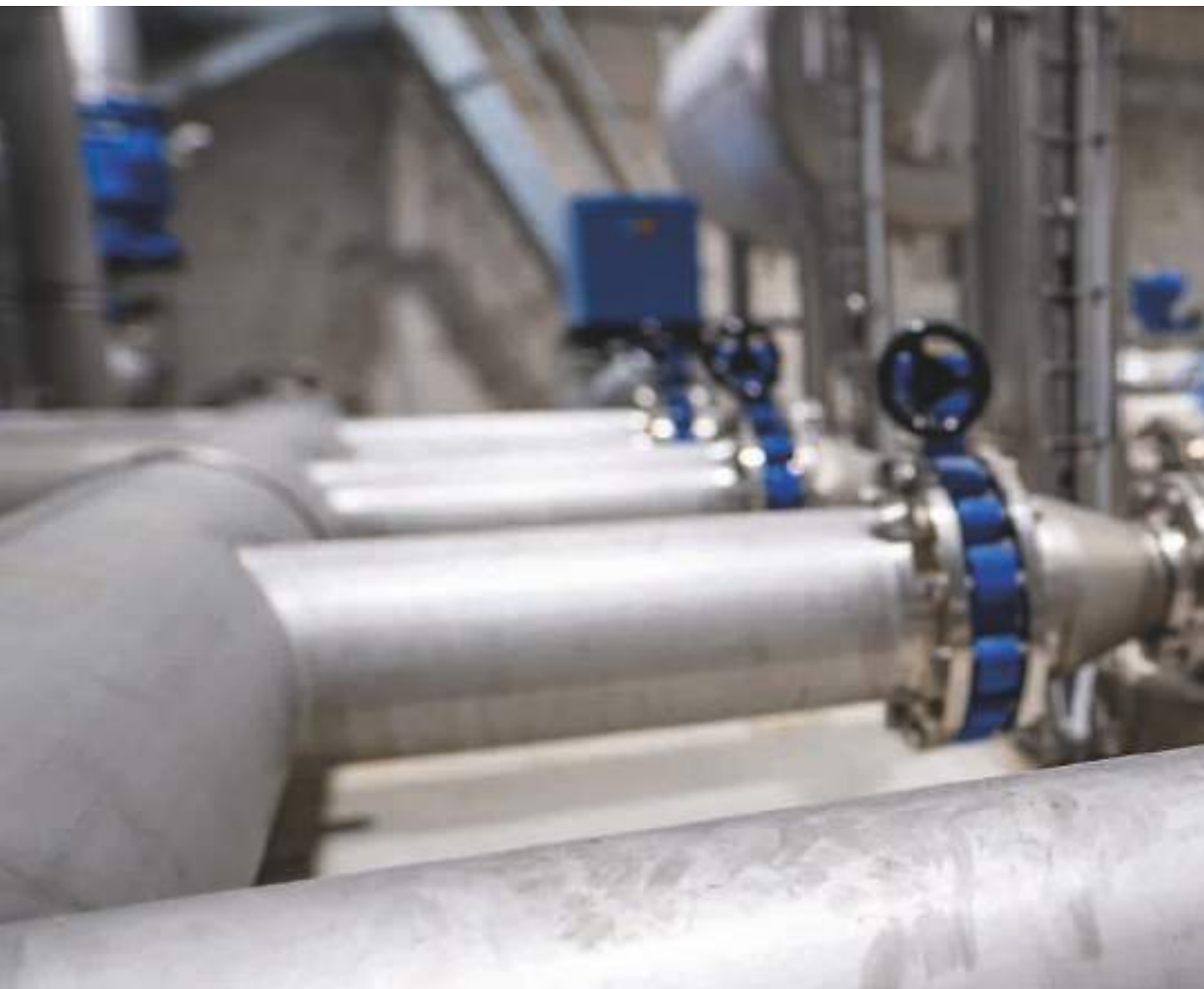
Les Calcaires de Florennes // Station de pompage
