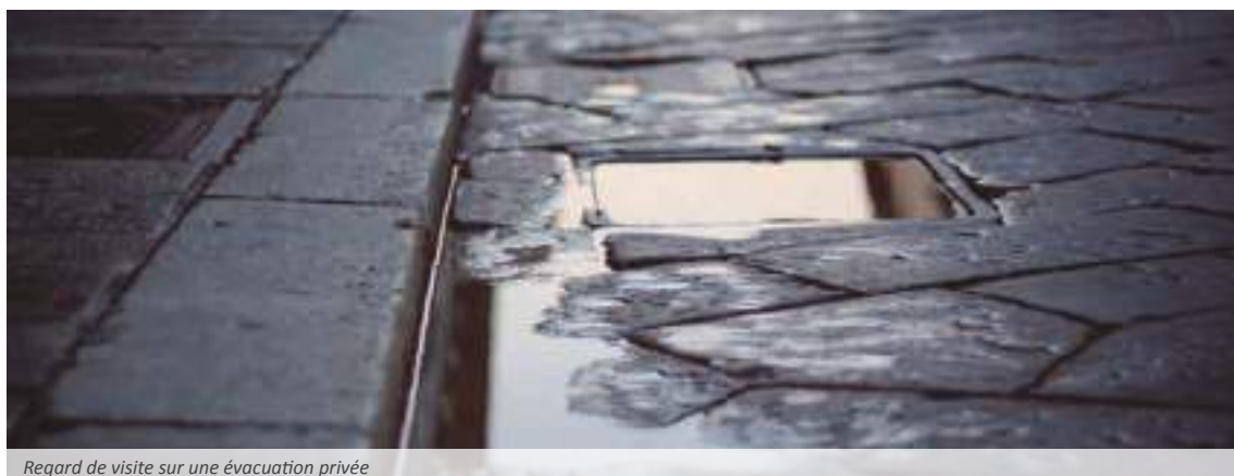
Regard de visite sur une évacuation privée
