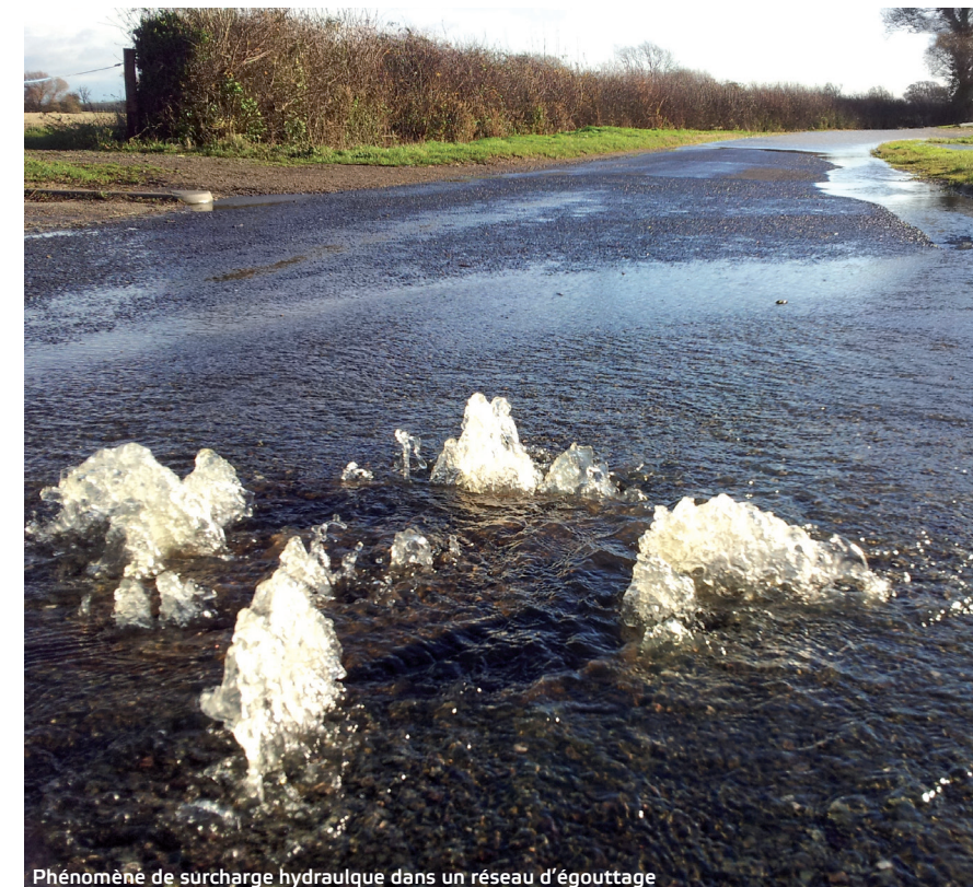
Phénomène de surcharge hydraulique dans un réseau d'égouttage
