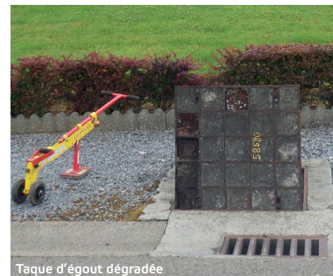
Taquet d'égout dégradé
