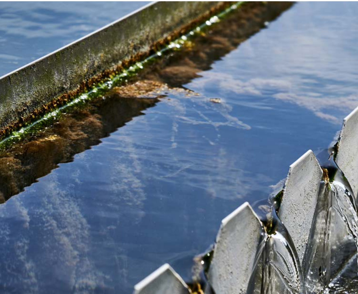
Dinant // Station d'épuration
