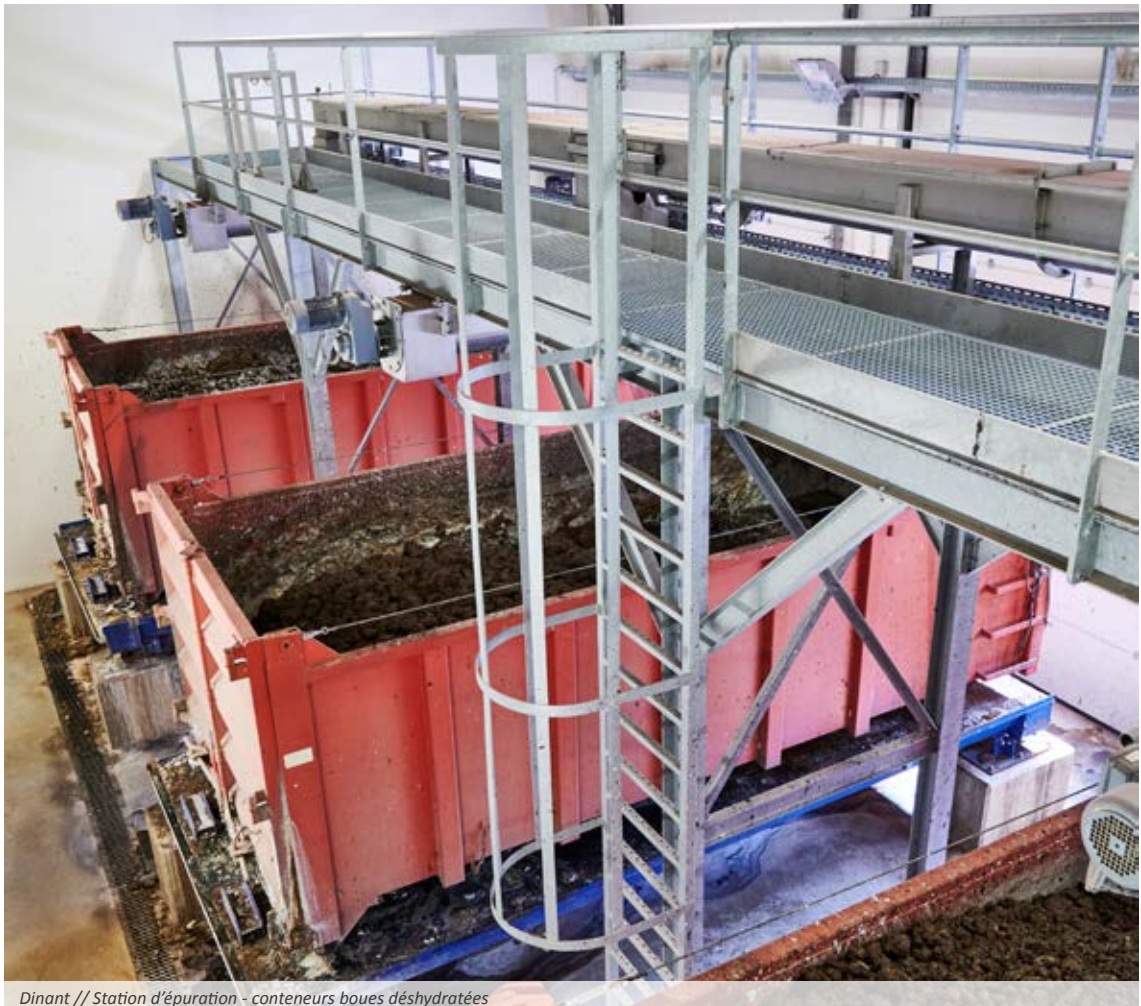
Dinant // Station d'épuration - conteneurs boues déshydratées
