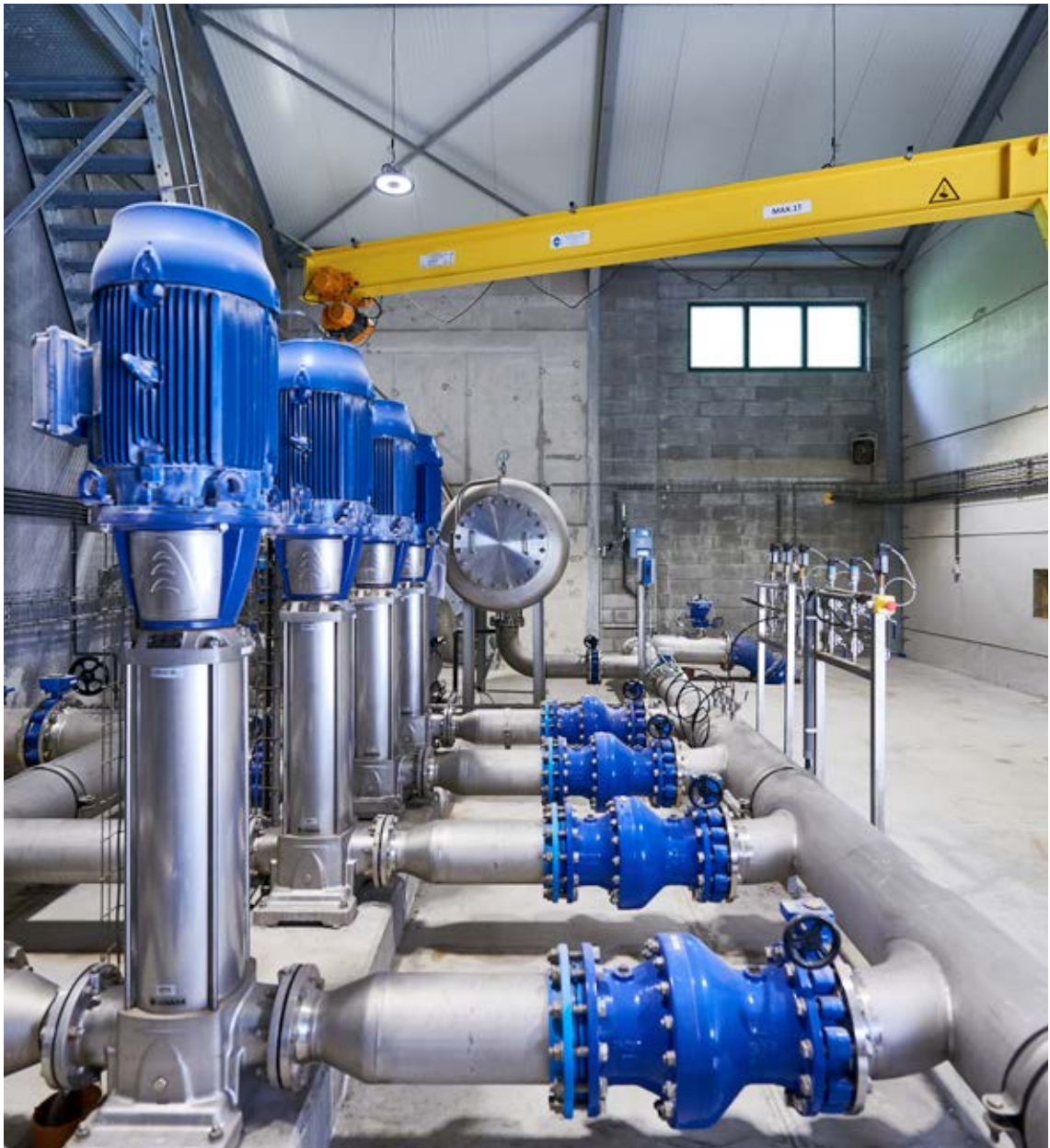
Florennes // Station de pompage
